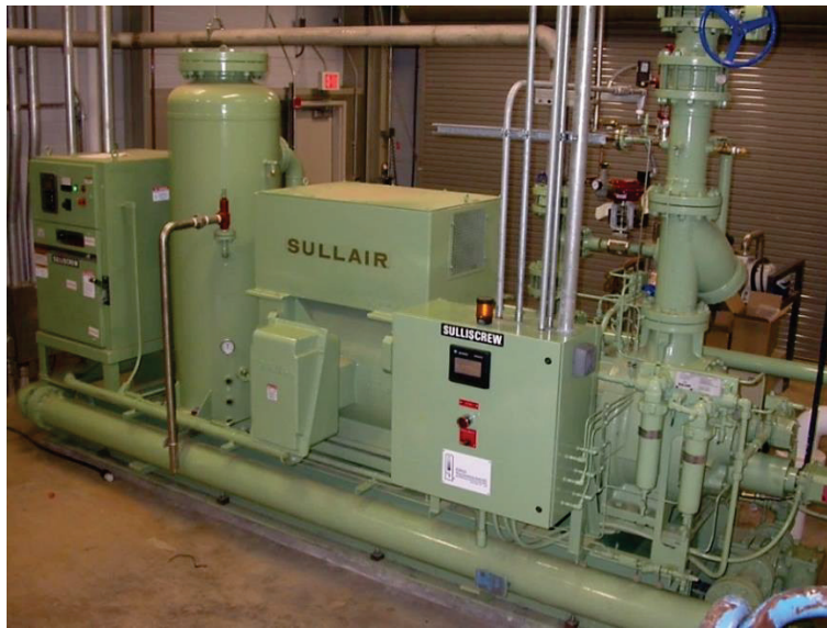
Fig. 4.27. FTS helium compressor.
